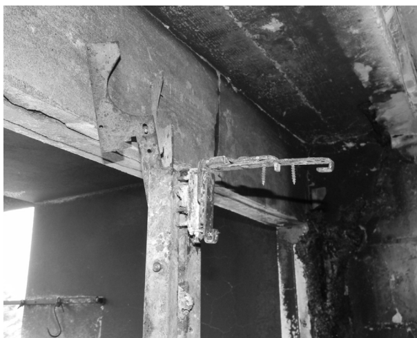
Слика 1. Детаљ металне конструкције прозора након пожара
