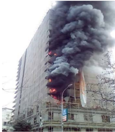
Слика 8 – Пожар на фасади јавног објекта у Скопљу 2016
