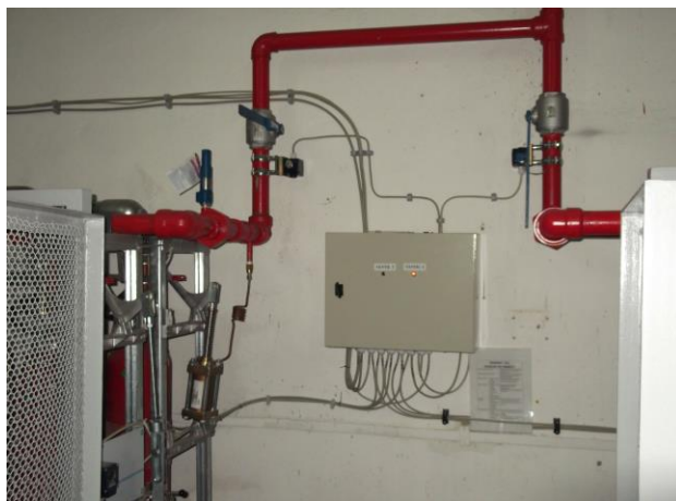
Слика 5 Приказ вентила бр.1 и бр.2
