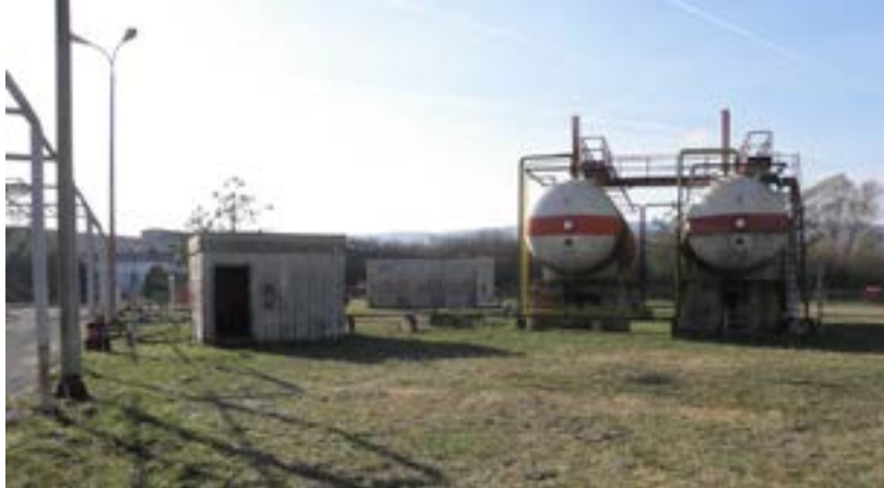
Slika 1. Plinski sustav spremnika UNP-a sa instalacijom kompresorske stanice sa pretakalištem te mjerno regulacijskom stanicom za snadbjevanje potrošača
