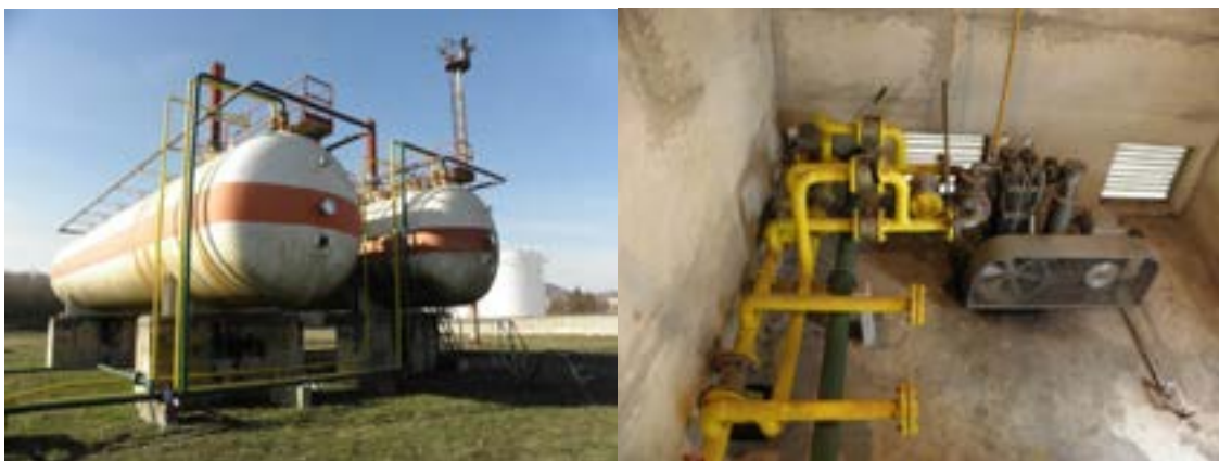
Slika 2. Cjevovod u prostoru spremnika UNP-a, Cjevovod u kompresorskoj stanici
