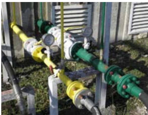
Slika 3. Cjevovod na pretakalištu UNP-a
