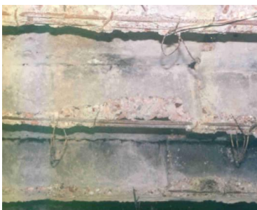
Slika 13. Karakteristična oštećenja sitnorebraste tavanice usled požara
