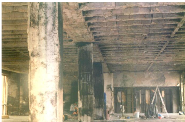
Slika 5. Izgled oštećene AB konstrukcije na VIII spratu nakon požara i čišćenja
