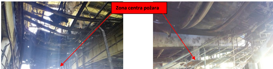
Slika 9. Zona centra požara posmatrana iz suterena Hale 2.
