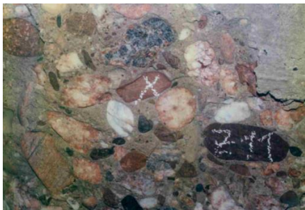
Slika 1. Pucanje i ispadanje zrna agregata (Aggregate spalling)
