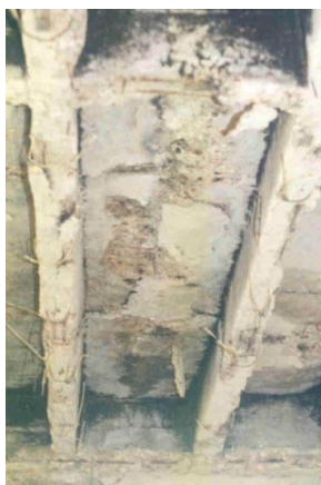
Slika 17. Uticaj defekata na stepen oštećenja sitnorebraste tavanice usled požara
