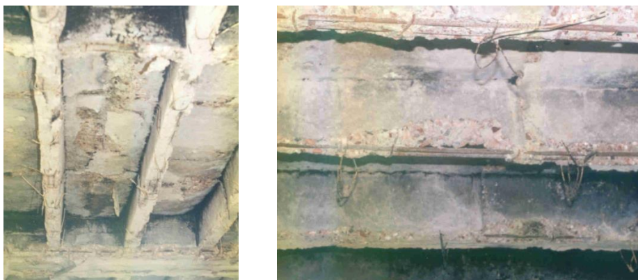
Slike 8 i 9. Karakterističan izgled sitnorebraste tavanice nakon požara
