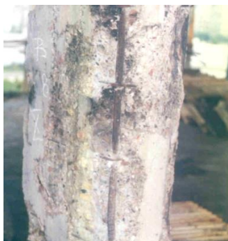
Slika 6. Karakterističan izgled AB stuba nakon požara
