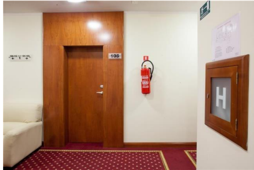
Slika 25. Aparat za gašenje i hidrant u hotelskoj sobi ( http://www.travelino.hr )
