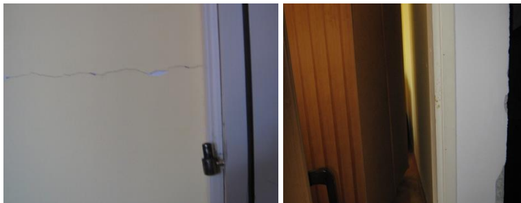
Slika 11. Pukotina na pregradnom zidu i ormar u spavaćoj sobi okrenut udarnim zračnim talasom
