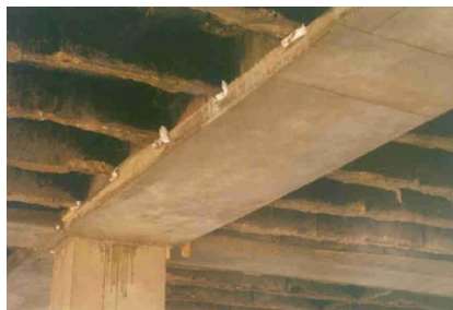
Slika 20. Izgled postojeće AB grede na kojoj je izveden novi zaštitni sloj betona na donjoj strani
