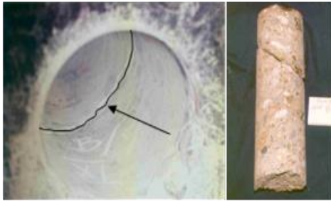
Slika 7. Unutrašnje raslojavanje betona (Inner delamination of concrete) u stubu
