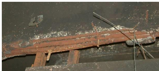
Slika 14. Karakteristična oštećenja AB rebra usled požara, izazvano nepravilnim rasporedom armature
