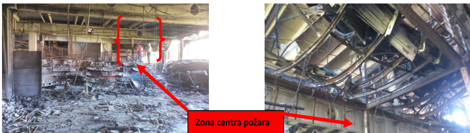
Slika 7. Zona centra požara posmatrana iz suterena Hale 2.
