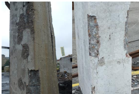
Slika 2. Odvajanje i opadanje komada betona duž ivica elemenata (Corner spalling), Pukotine uz ivice (Corner cracks)
