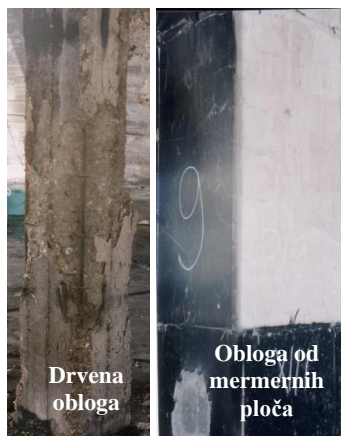
Slika 18. Uticaj vrste dekorativne obloge na stepen oštećenja stubova usled požara
