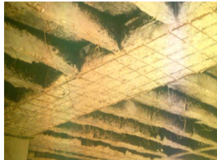
Slike 17 i 18. Uklanjanje oštećenog zaštitnog betonskog sloja i bušenje otvora u ploči sitnorebraste tavanice
